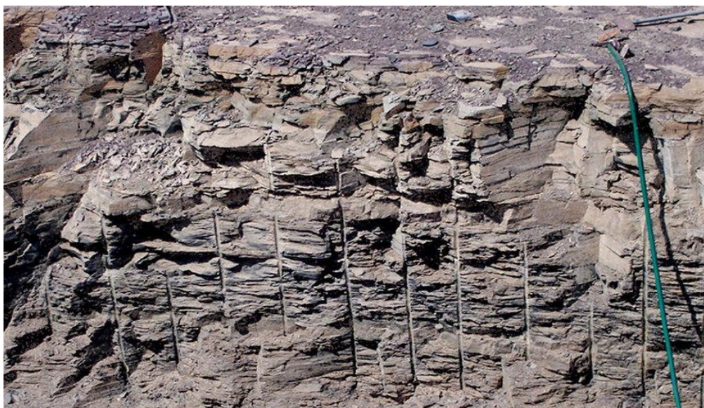
Рисунок 2.16 – Нарушение геометрии откоса при несоблюдении параметров щелеобразования
